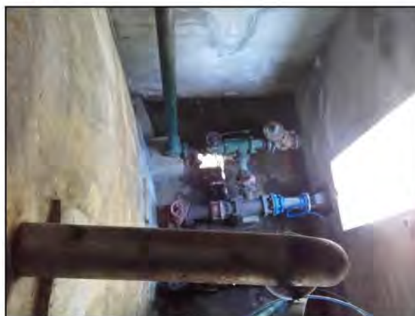
Photo 10: chambre des vannes du réservoir de Beaujean
