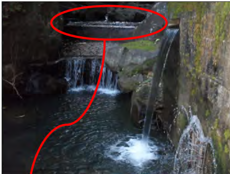
Photo 1 absence de ligne de vie sur le captage de Beausoleil et affouillement des ouvrages
