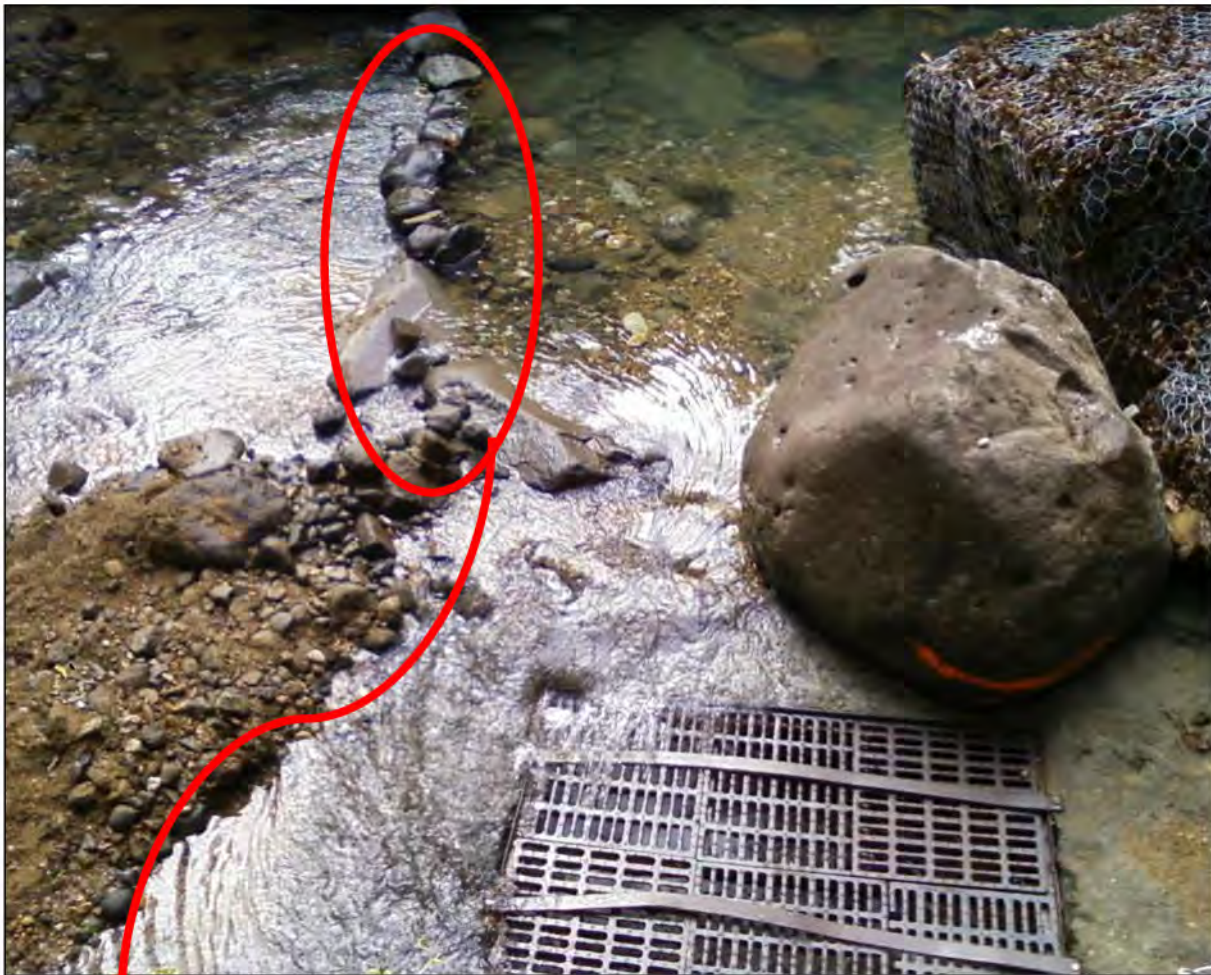
Photo 4 : Captage de l'UPEP des Plaines
