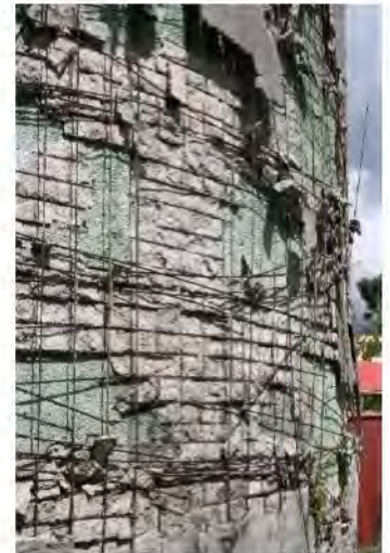
Photo 1 dégradation du revêtement extérieur du réservoir de Beauregard à Bouillante :
